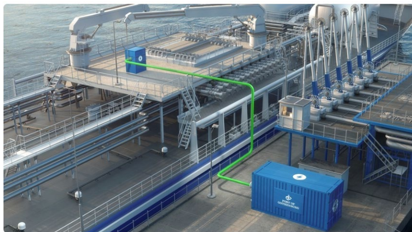
Figure 12. Système de batteries de stockage d'énergie, Port de Göteborg, 2022
